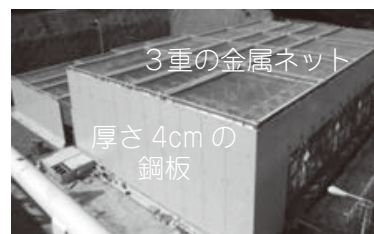
(3, 4号機海水ポンプ)
