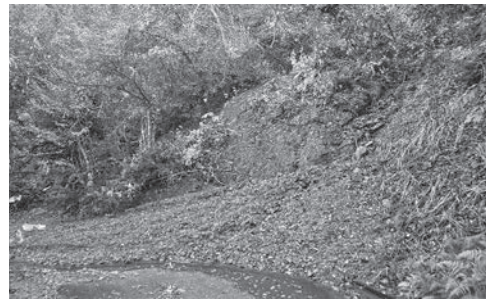
五波峠(名田庄染ヶ谷)の崩落現場
