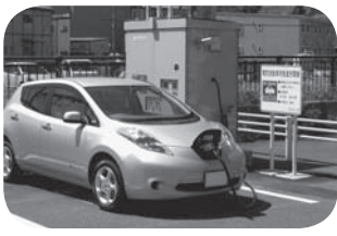
急速充電設備
