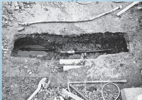
名田庄東中部地区で漏水事故により取り替えた鉛管
